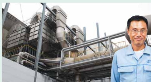
排ガス浄化設備
