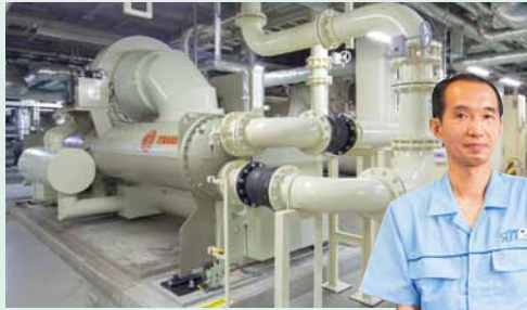
空調 ターボ冷凍機
