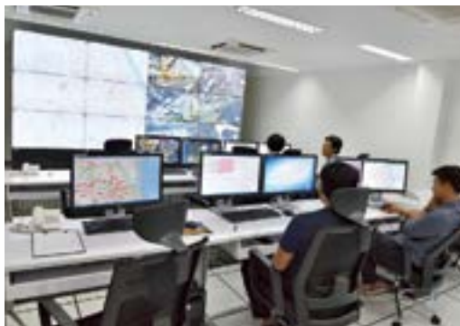
交通管制センター
