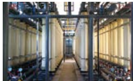
四川省簡陽市石盤鎮污水处理場に納入された当社製水処理膜モジュール
