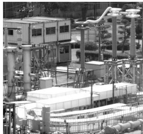
写真4 400kV 級 PQ 試験実施状況
