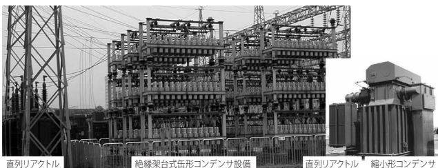
写真6 69kV 40Mvar 電力用コンデンサ設備の比較
